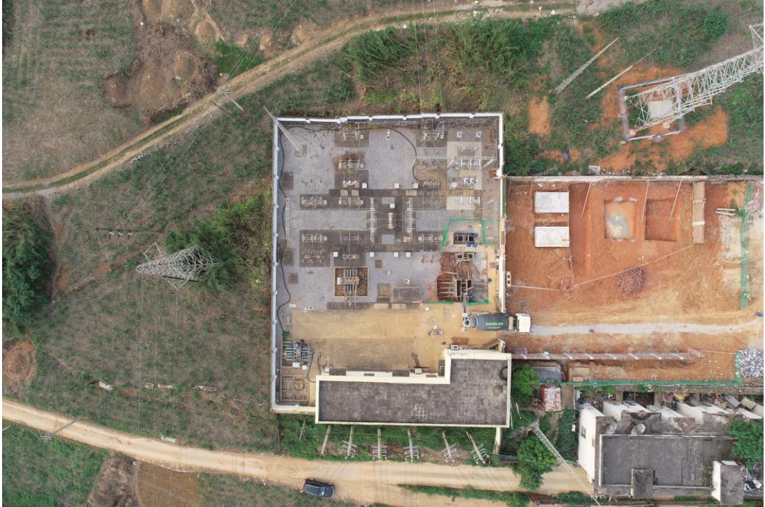
35kV 天西变电站现状
